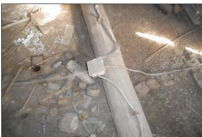
A jelenlegi elektromos vezeték szabadon a padlástérben vannak, ami esőzések, nagyobb havazások alkalmával beázik.
